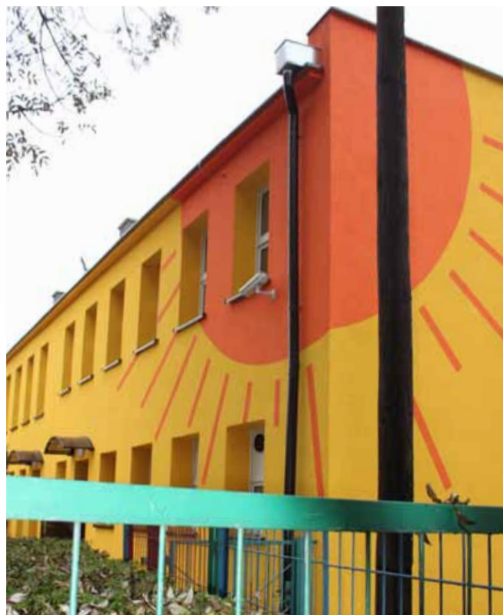
Tarnobrzeg „jedenastka” ma nową „słoneczną” elewację. Budynek przedszkola przeszedł nie tylko lifting, ale przede wszystkim kompleksowe prace, w ramach których przeprowadzono termomodernizację obiektu. Inwestycja uzyskała wsparcie finansowe Wojewódzkiego Funduszu Ochrony Środowiska i Gospodarki Wodnej w wysokości 70 496,62 zł.
